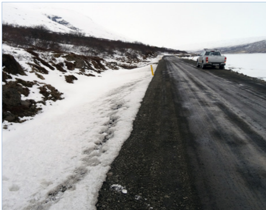
Skriðdals- og Breiðdalsvegur (95), Skriðuvatn – Axarvegur, 9. apríl 2018.
