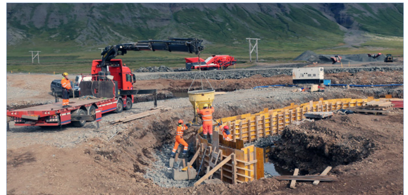
Vestfjarðavegur (60), tenging Dýrafjarðarganga í Arnarfirði, steyptur sökkull fyrir nýja brú á Hófsá, 27. ágúst 2018.
